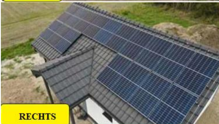
Abb.4 Beispiel einer Fotodokumentation einer Photovoltaikanlage - VERPFLICHTET VOM HERSTELLER
