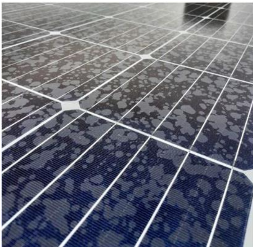
Abb.2 Feuchte unter dem Glas
